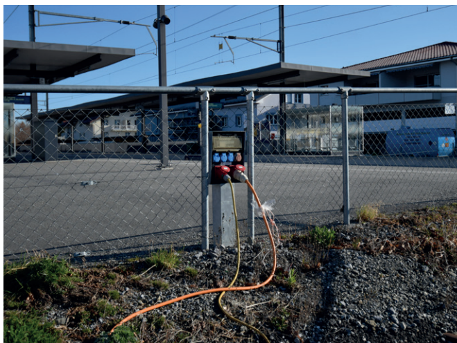
Quadro distribuzione presso la stazione Oberriet
