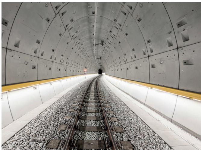
LaneLED GFK, galleria Glatscheras
